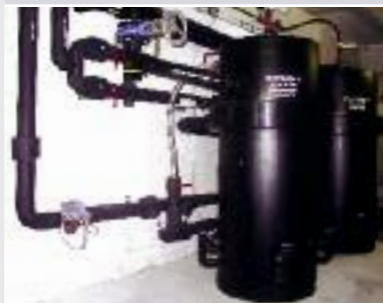
Wärmerückgewinnungsanlage im Hallenbad der Stadt Dornbirn
